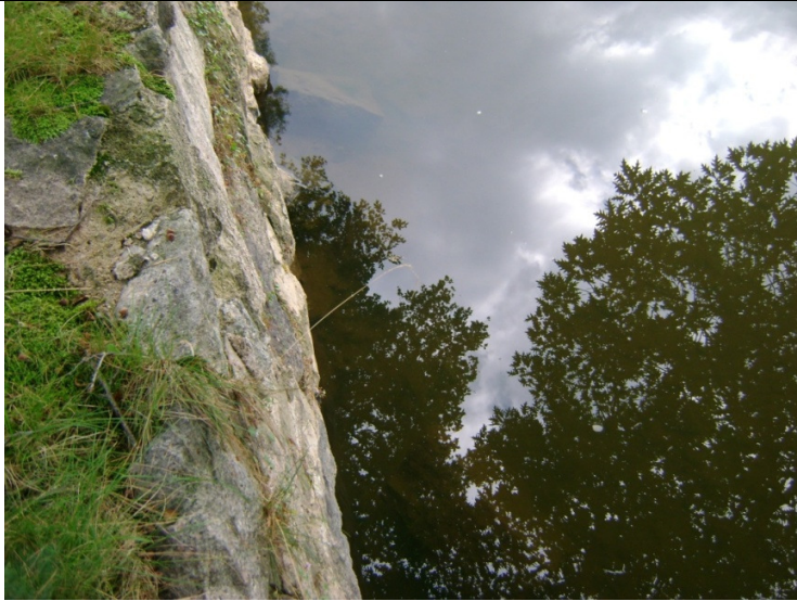
Fot 3 – Mur M1/2 – brak opaski przynurtovej
