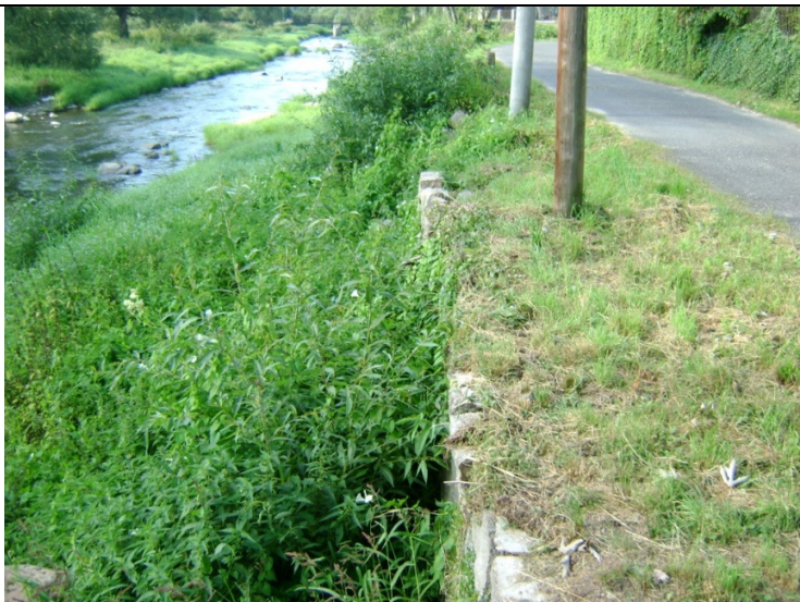
Fot 4 – Mur M3 – uszkodzona konstrukcja muru w rejonie słupa energetycznego
